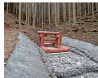
簡易流木止め施設
