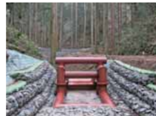
簡易流木止め施設
