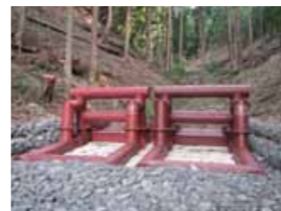
簡易流木止め施設
