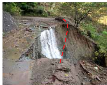
写真2 台風21号により林道の路体が流出(天谷尾ノ谷線 養父市)
