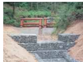
簡易流木止め施設
