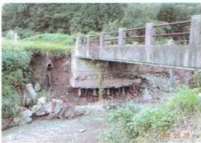
林道橋の被災状況
