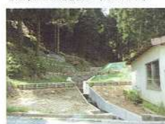
安定した流木の発生を抑えるための土砂捕捉と流木止め施設(豊岡市)
