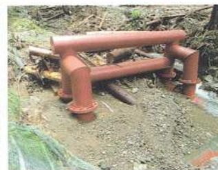
簡易流木止め施設
