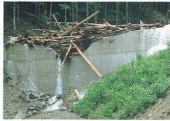
土砂・流木を捕捉した治山ダム (丹波市)
