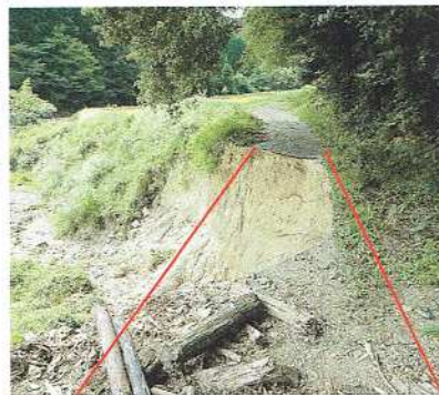
写真3 路肩崩壊 (丹波市 相原線)
